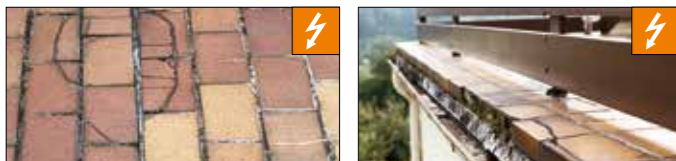
Takim uszkodzeniom możecie Państwo zapobiec stosując system firmy Schlüter.
